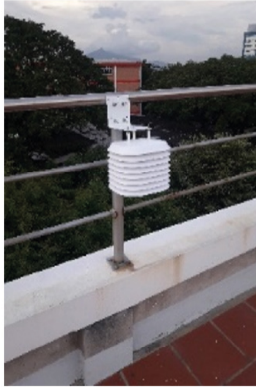
Figura 12. Instalación de equipo de medición de las condiciones exteriores, Testigo_C_Ext.
