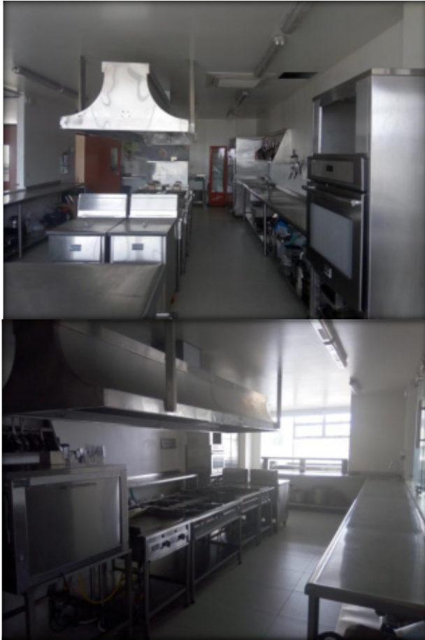
Vista de la cocina industrial
