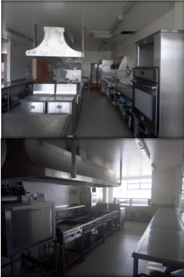
Vista de la cocina industrial
