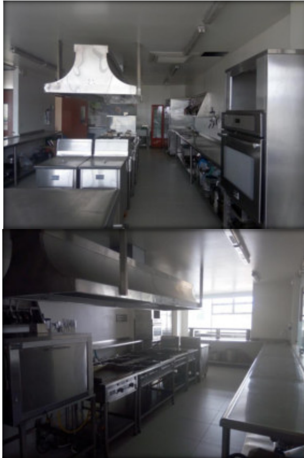
Vista de la cocina industrial
